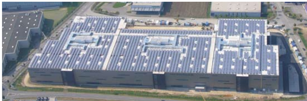
1MW-Anlage, Aufdachanlage, Holy-AG (Deutschland)
