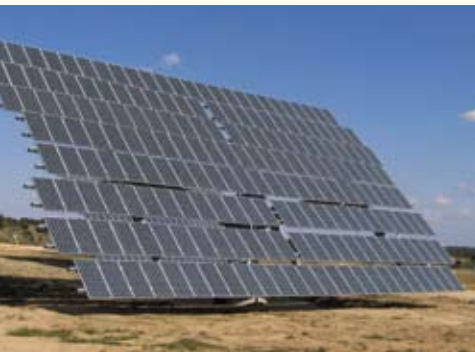
400kW-Anlage, Trackersystem (Spanien)
