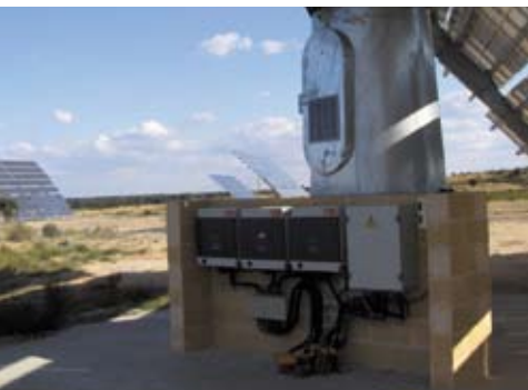
400kW-Anlage, Trackersystem (Spanien)
